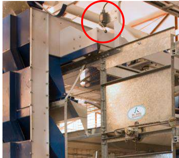
Interruptor de límite en el carro autopropulsable.
