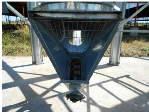
Bota de tolva del sistema de llenado.
