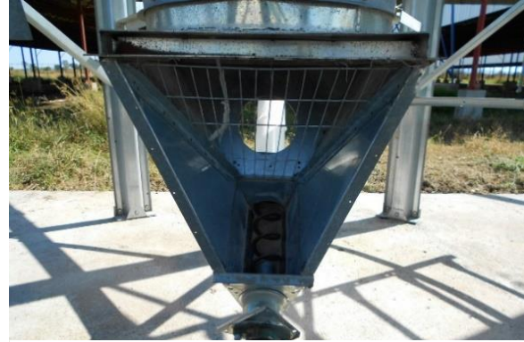
Bota de tolva del sistema de llenado.
