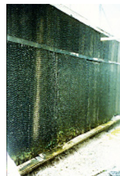
CELdek en mal estado
